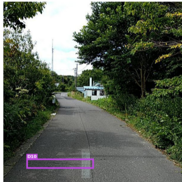
(b) Trinca transversal
